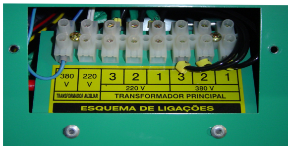
Ligação em 380V (Trifásico)
