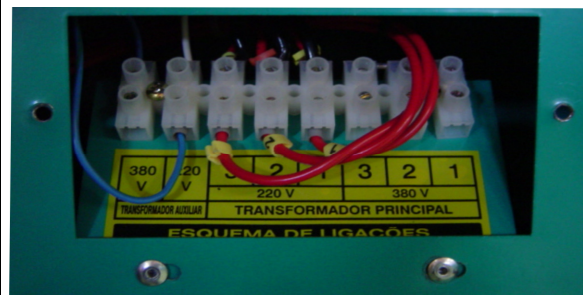
Ligação em 220V (Trifásico)
